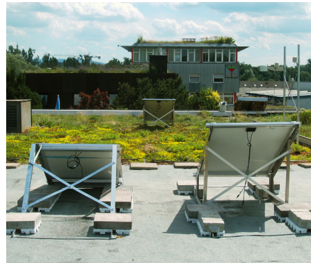
Abb. 134: links: Photovoltaik-Aufdachanlage mit Dachbegrünung (Foto: ZinCo GmbH)
