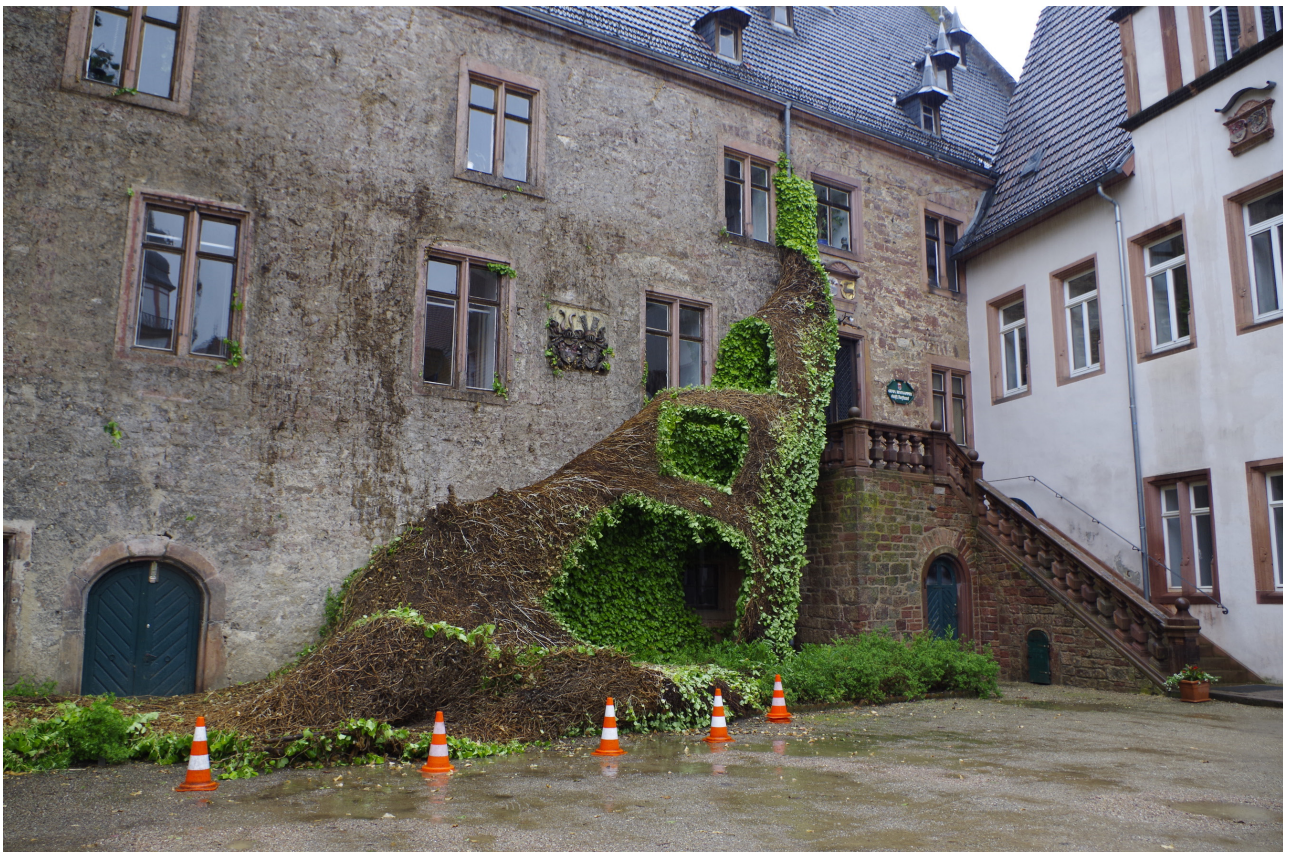
Abb.: unten: Bodengebundene Fassadenbegrünung (Schlosshof Erbach i. Odenwald, 2013): Abriss des gepflegten Efeu- Bewuchses durch Belastung nach Starkregen. Eine Gewichtsentlas- tung der Direktbegrünung durch Verankerung ins Mauerwerk hätte den Schaden vermeiden können. (Foto: Jörg Dettmar 2013)
